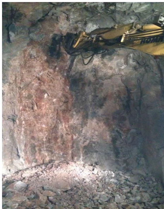
Figura 36 - Saneamento do topo de uma frente onde se verifica a remoção do material fracturado.
